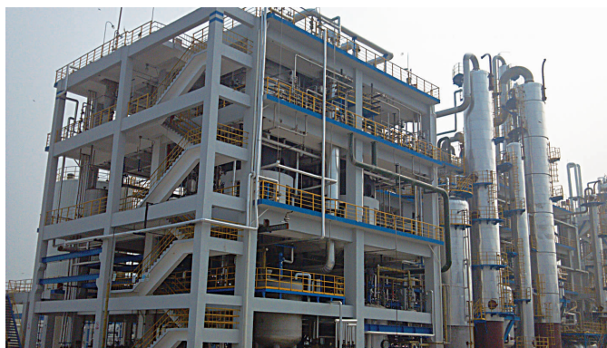
山东东巨氨脲化反应分离工业化装置
