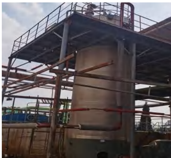
抗生素废水臭氧催化氧化脱毒技术应用现场
