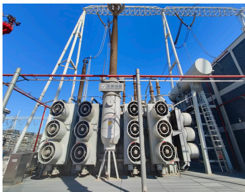
1000kV 低噪声变压器在特高压保定站应用
