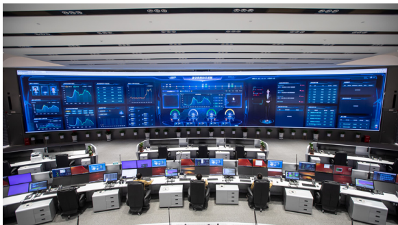
一体化智慧调控平台
