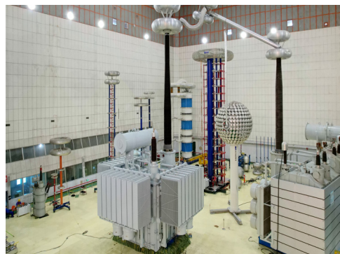
天威保变 1000kV 低噪声特高压并联电抗器通过型式试验
